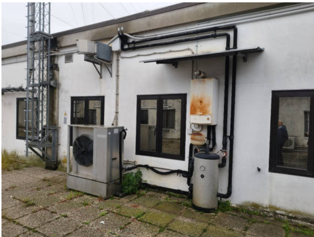
Particolare impianti di riscaldamento/raffrescamento
